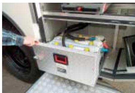
Abb. 3.3.7/5: Batterie in einem Staukasten am Heck eines Rüstwagens (Foto: Bildstelle der Feuerwehr Düsseldorf)
