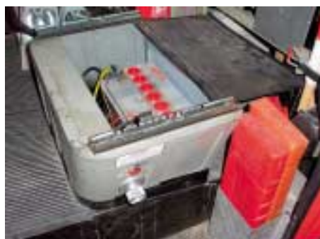
Abb. 3.3.7/3: Batterie unter dem Fahrersitz eines Transportes (Foto: Heck)
