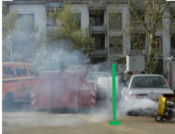
Propellerlüfter (2 Schritte Abstand)
